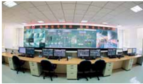
五七管业生产线中控室
